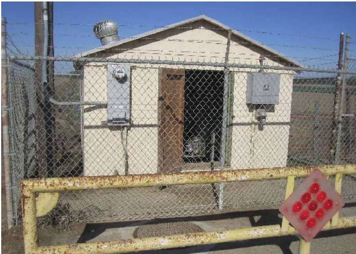
Figura 9-3 Estación de elevación de Pioneer Street
