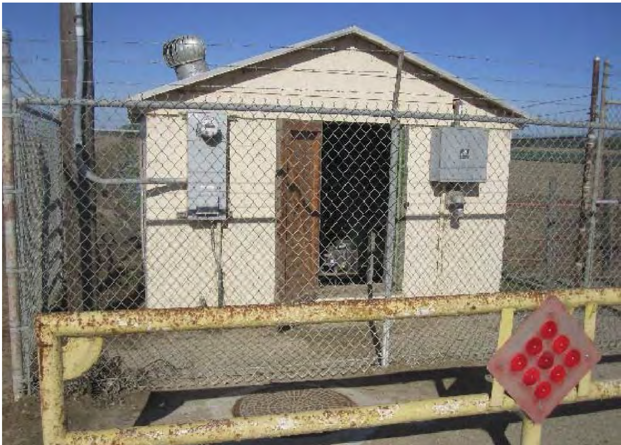
Figura 9-3 Estación de elevación de Pioneer Street
